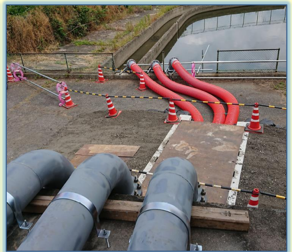
〔完成までの期間設置している仮設ポンプ〕
