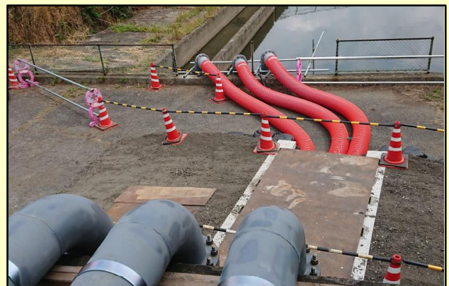
〔設置された仮設水中ポンプ〕
